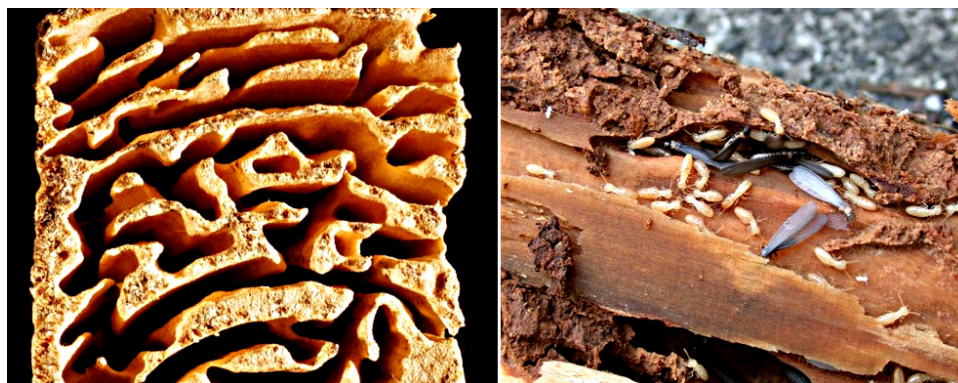
Figura 1: Izq. Ejemplo de túneles en una pieza de madera, excavados por una colonia híbrida de termitas ( Coptotermes formosanus y C. gestroi ) en Florida, EEUU (Fotografía proporcionada por Thomas Chouvenec ). Der. Ejemplo de tuneles y cámaras en una colonia de Reticulitermes speratus .
